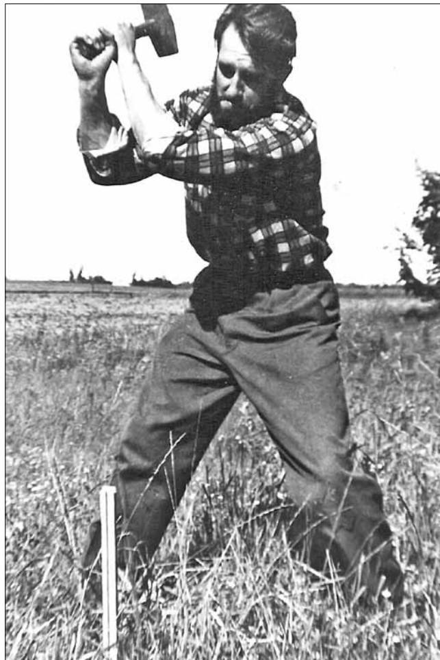
Min gamle klassekammerat, tømrermester Knud Jørgensen, afsætter til støbning af fundament i 1959. Privatfoto.
